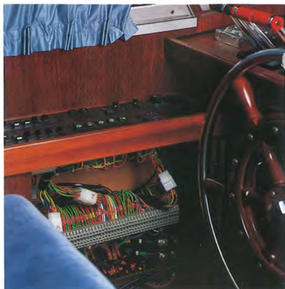
Under panelen vid centralen är allt lätt-överskådligt och servicevänligt. Inga lösa sladdar eller "skatbon".
